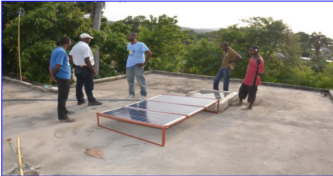
Drie zonnepanelen op het dak van Fondation L'École verte d'Haïti.
